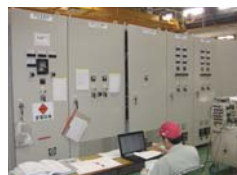
各種電気工事・制御盤
